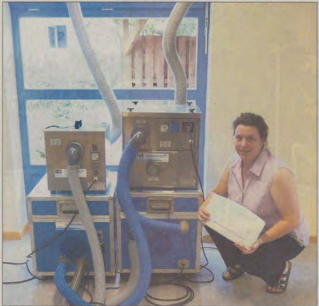
Bürgermeisterin Dr. Kathrin Wrobel mit Geräten, die Wasser aus dem Gebäude schaffen sollen.
